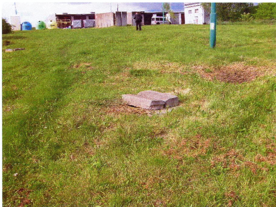
Studzienki kanalizacyjne i latarnia uliczna w zachodniej części działki
